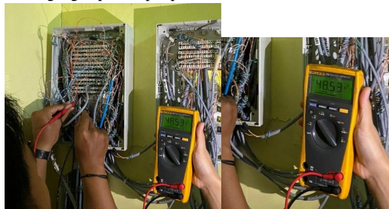
Gambar 4. Pengecekan Tegangan Input VSCS
