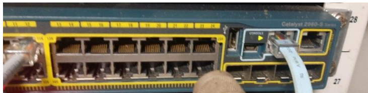
Gambar 3. Port Switch yang Dihubungkan
