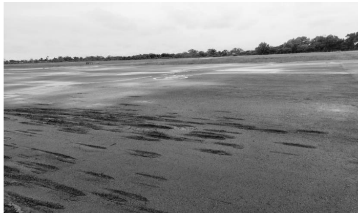
Gambar 2. Kondisi permukaan parking stand
