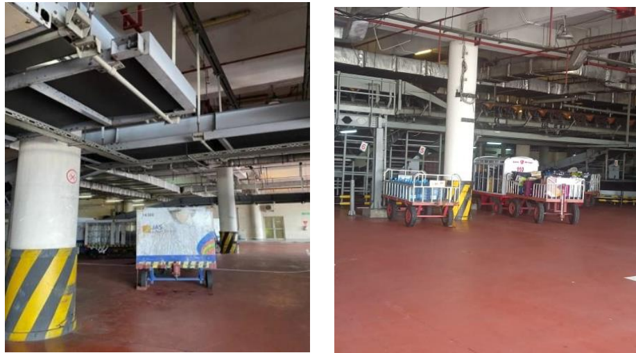
Gambar 4. Penempatan Peralatan BTT Tidak Sesuai SOP
